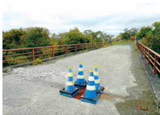
改修工事が待たれる二本松橋
