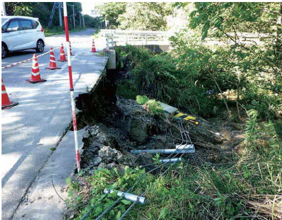
大雨による法面被害
