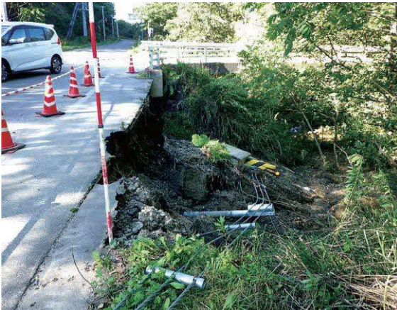
大雨による法面被害
