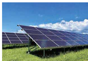
太陽光パネル
