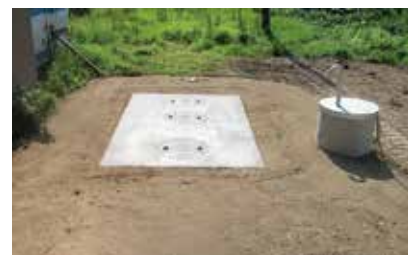
合併処理浄化槽
